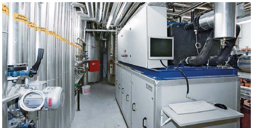
Eine Abwasser-Wärmepumpe mit 150 kW Leistung für die Trinkwassererwärmung
