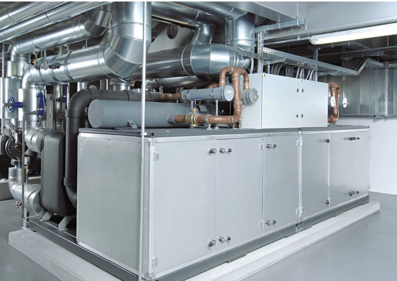
Diese Wärmepumpe nutzt die Abwärme und kühlt gleichzeitig das Rechenzentrum sowie die Geräteprüfstände am Viessmann Standort Allendorf
