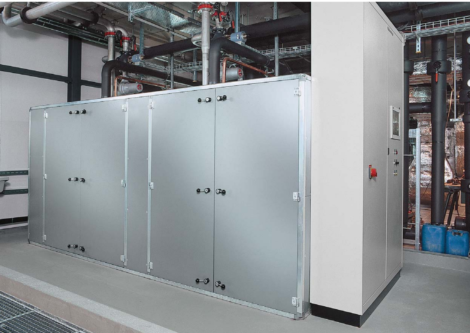
Wasser/Wasser-Wärmepumpe mit einer Heizleistung von 500 kW
