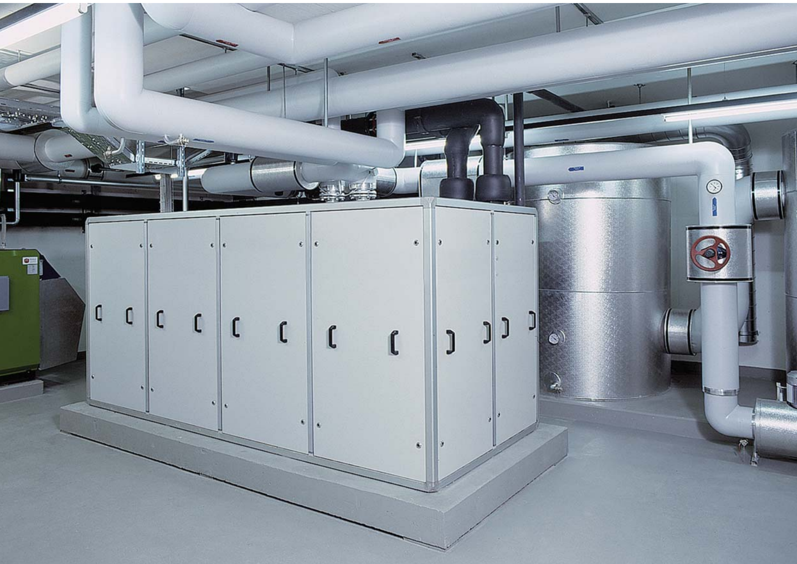
Sole/Wasser-Wärmepumpe mit einer Heizleistung von 290 kW
