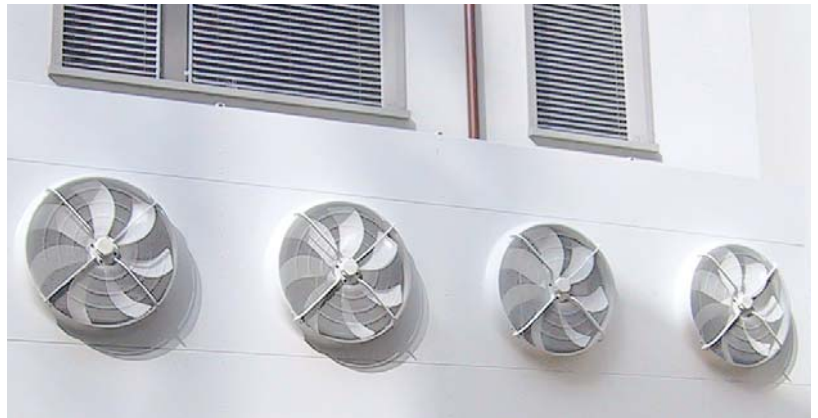
Glykol-Rückkühler als integrierte Fassadenlösung für Luft/Wasser-Wärmepumpen
