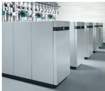
Technikraum in Manisa (Türkei) mit fünf Vitocal 300-G Pro Wärmepumpen zur Gebäudeklimatisierung
