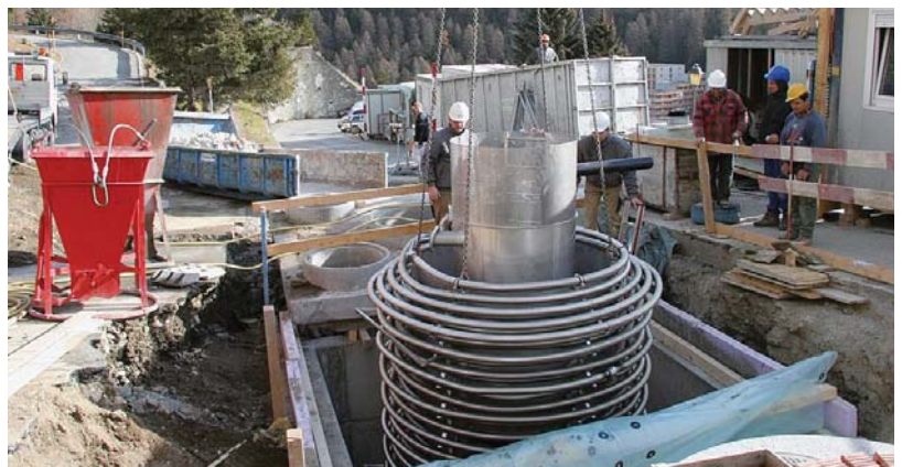
Dieser Abwasserschacht dient als Primärquelle zur Warmwasseraufbereitung.
