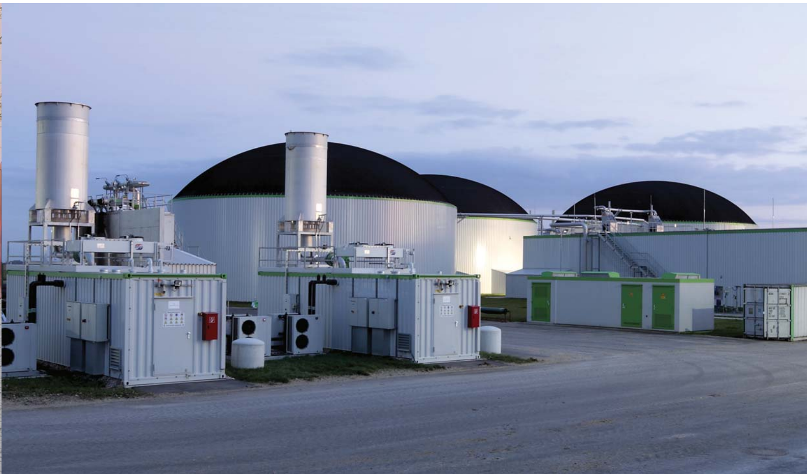
Energie aus einer Biogasanlage ist die Grundlage für regenerative Wärme- und Stromversorgung einer Kommune.
