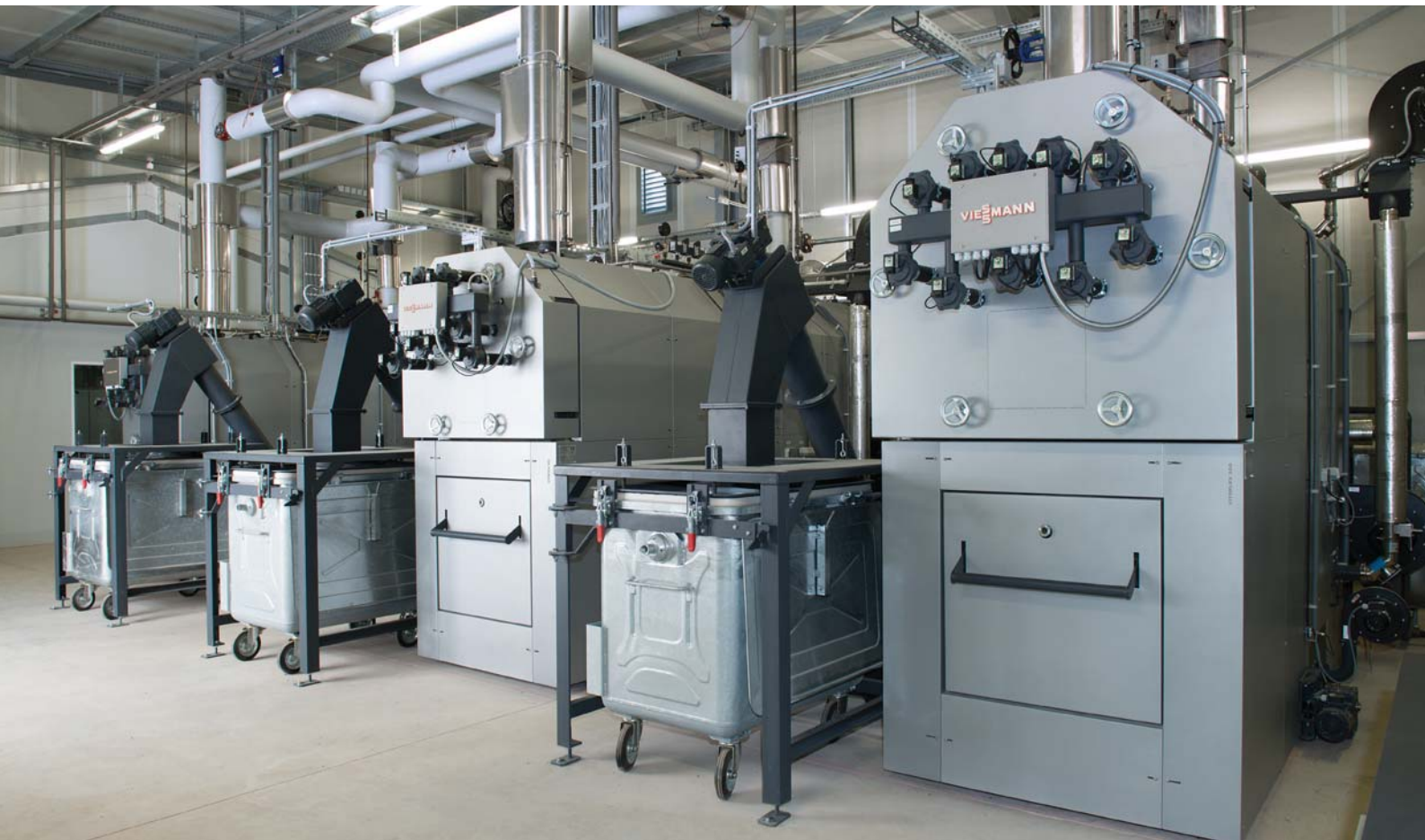
Heizkraftwerk mit Biomassekesseln
