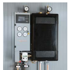
Übergabestation beim Wärmeabnehmer
