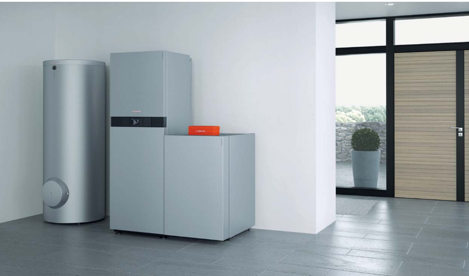
Sole/Wasser-Wärmepumpe Vitocal 300-G, Stromspeicher- System Vitocharge sowie Warm- wasserspeicher Vitocell 100-V (von rechts)
