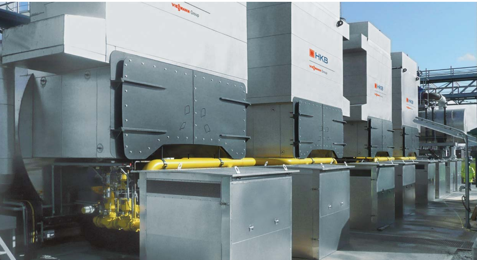
Doppelflammrohrkessel zur Dampferzeugung
