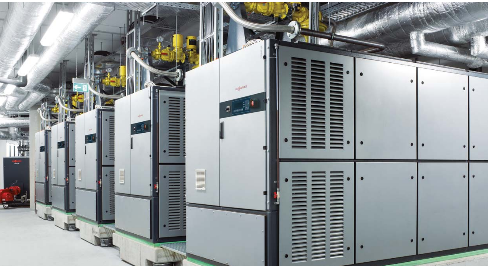
Die Energiezentrale der DGUV mit fünf Blockheizkraftwerken in St. Augustin
