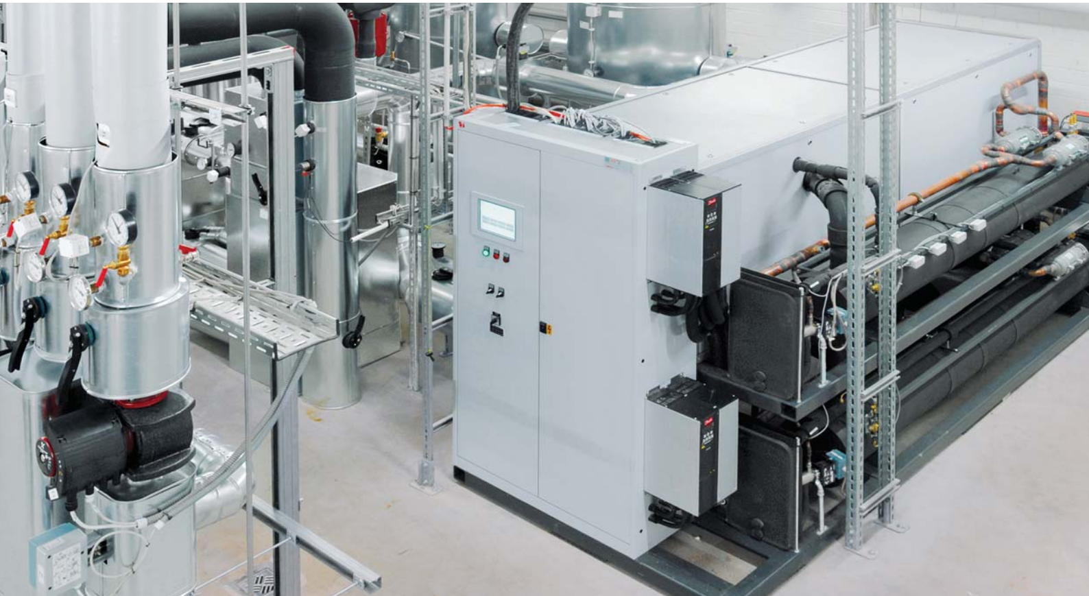
Großwärmepumpe zum Heizen und Kühlen
