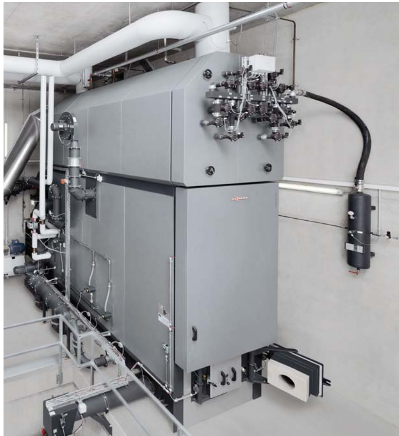
Heizwerk in Gräfelfing mit Biomassekessel (rechts) und Heißwassererzeuger für die Spitzenlast
