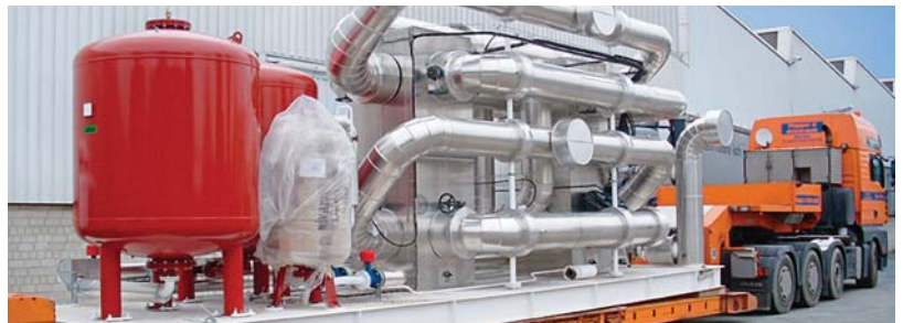
Hoher Vormontagegrad von aufeinander abgestimmten Komponenten
