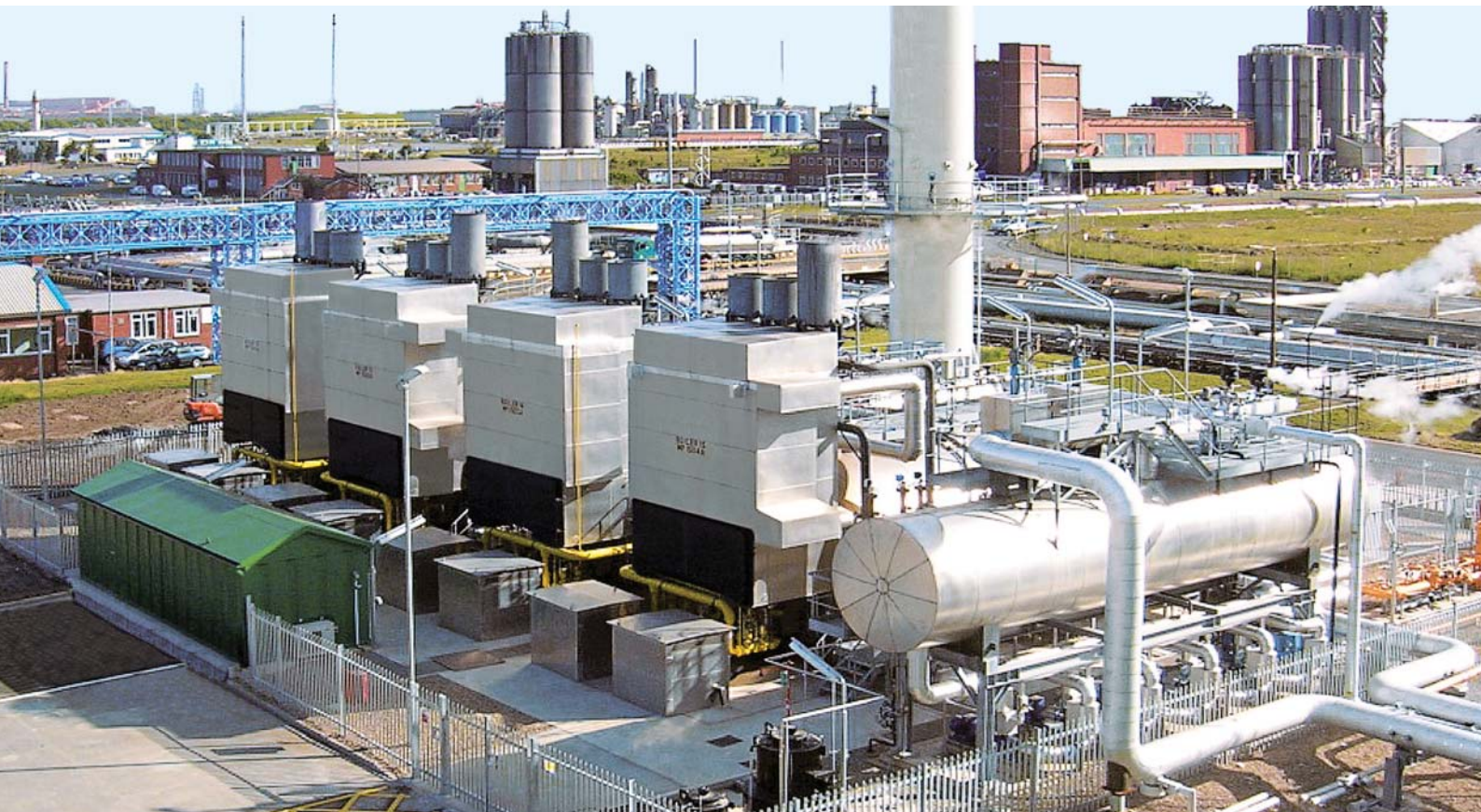
Semcorp Utilities, Wilton (Großbritannien)
