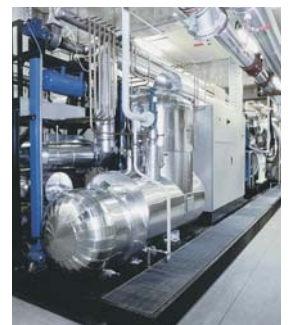
ORC-Anlage zur Stromerzeugung
