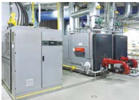
Blockheizkraftwerk (links) im Badeparadies. Zwei Vitoplex Kessel liefern bei Bedarf die Spitzenlast.
