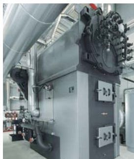
Dampfkessel mit Biomassefeuerung
