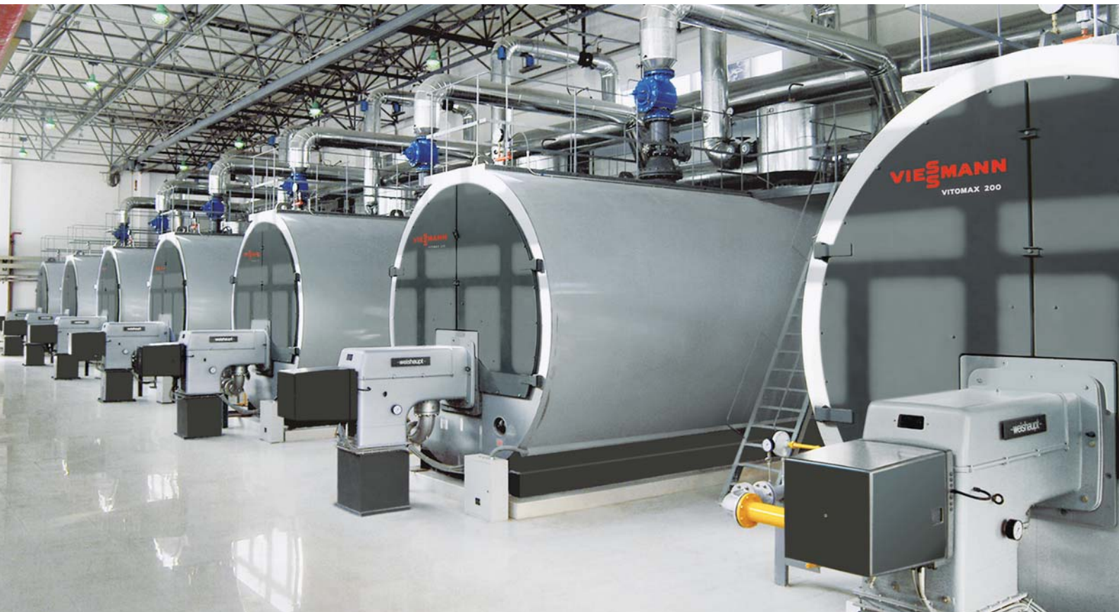
Heißwasserkessel mit Gasbrennern
