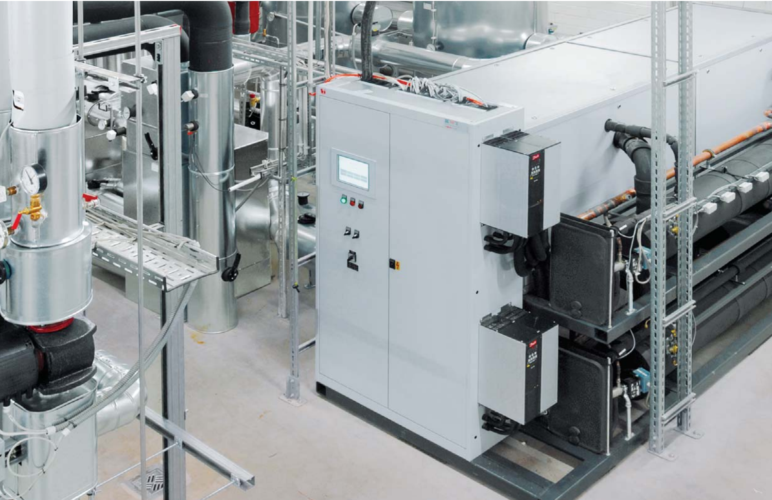
Leistungsstarkes Heizsystem mit einer Viessmann Großwärmepumpe
