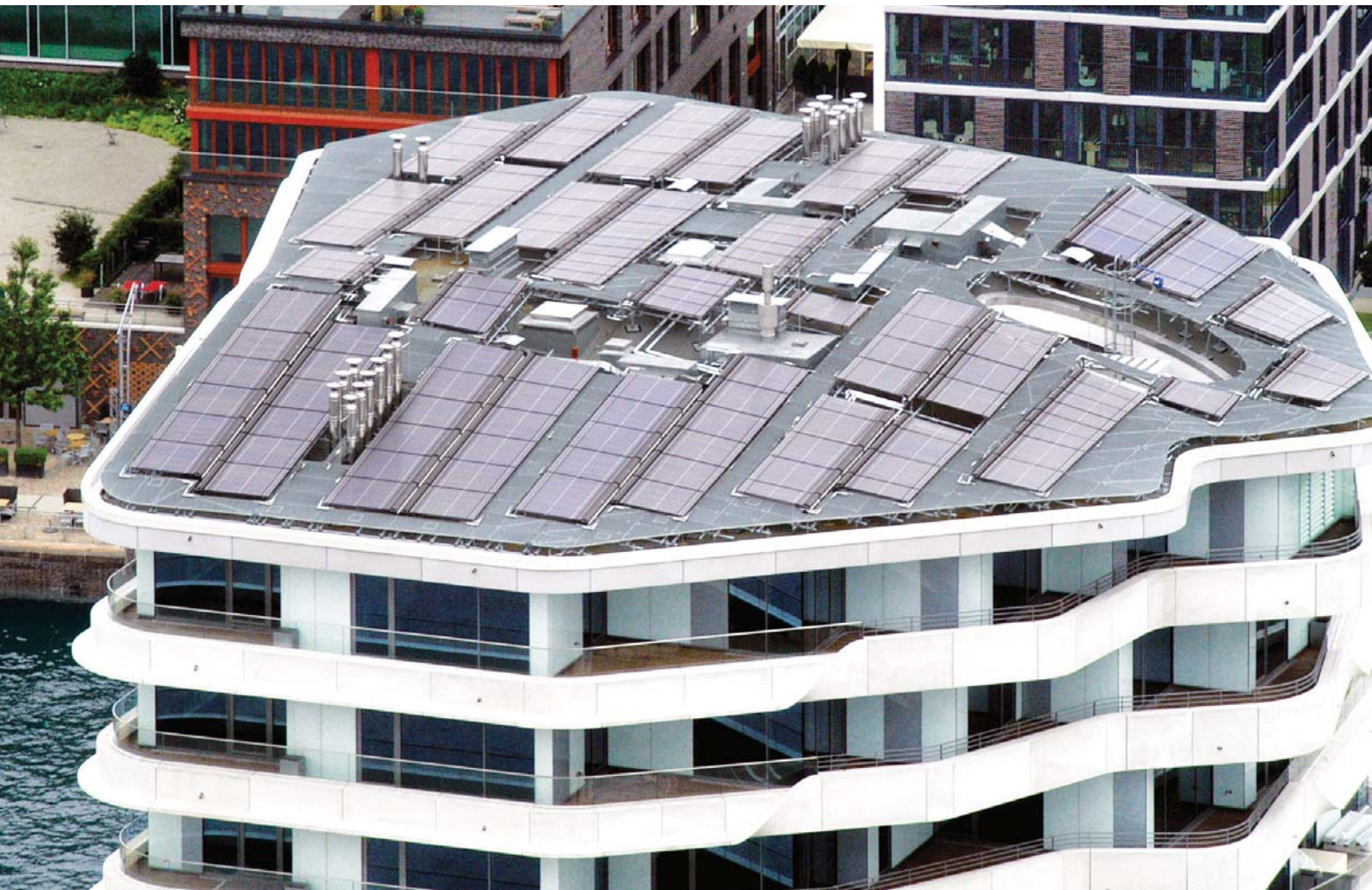
Thermische Solaranlage auf dem Marco Polo Tower in Hamburg
