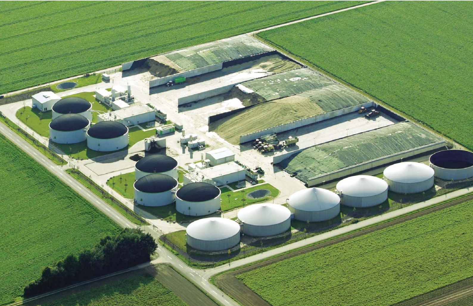
Anlage zur Erzeugung von Biogas durch Nassfermentation
