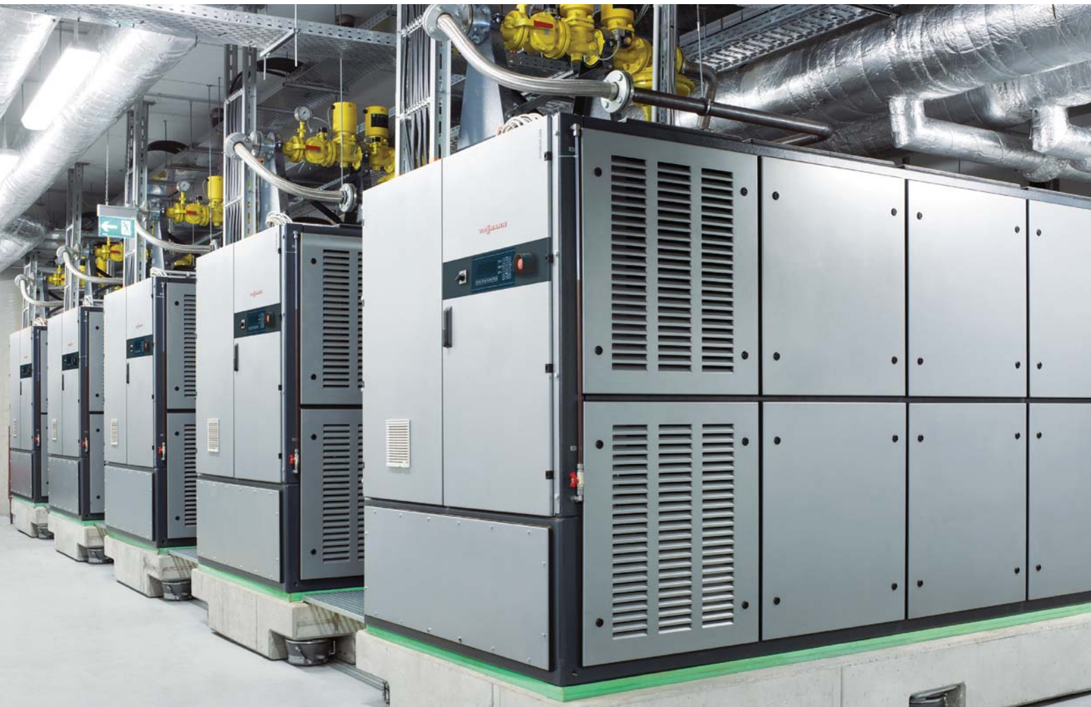
Energiezentrale mit fünf Blockheizkraftwerken Vitobloc 200 (238 kW e /363 kW th )
