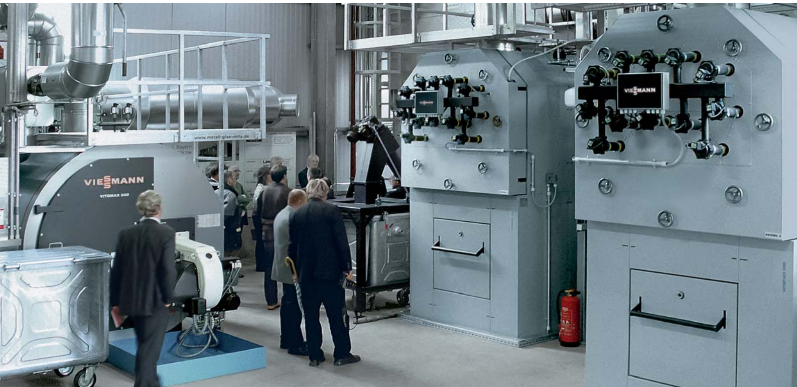
E.ON-Biomasse-Heizwerk, Markt Schwaben, Deutschland
