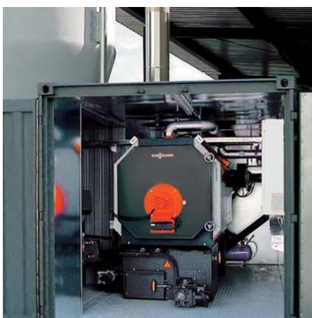
Mobile Wärmezentrale im Container
