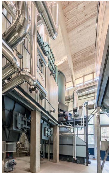
Blick auf den Thermoölkessel und den Stufenrost
