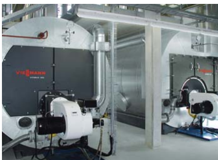
Dampferzeuger mit Abhitzenutzung in Kombination mit einem konventionellen Dampfkessel
