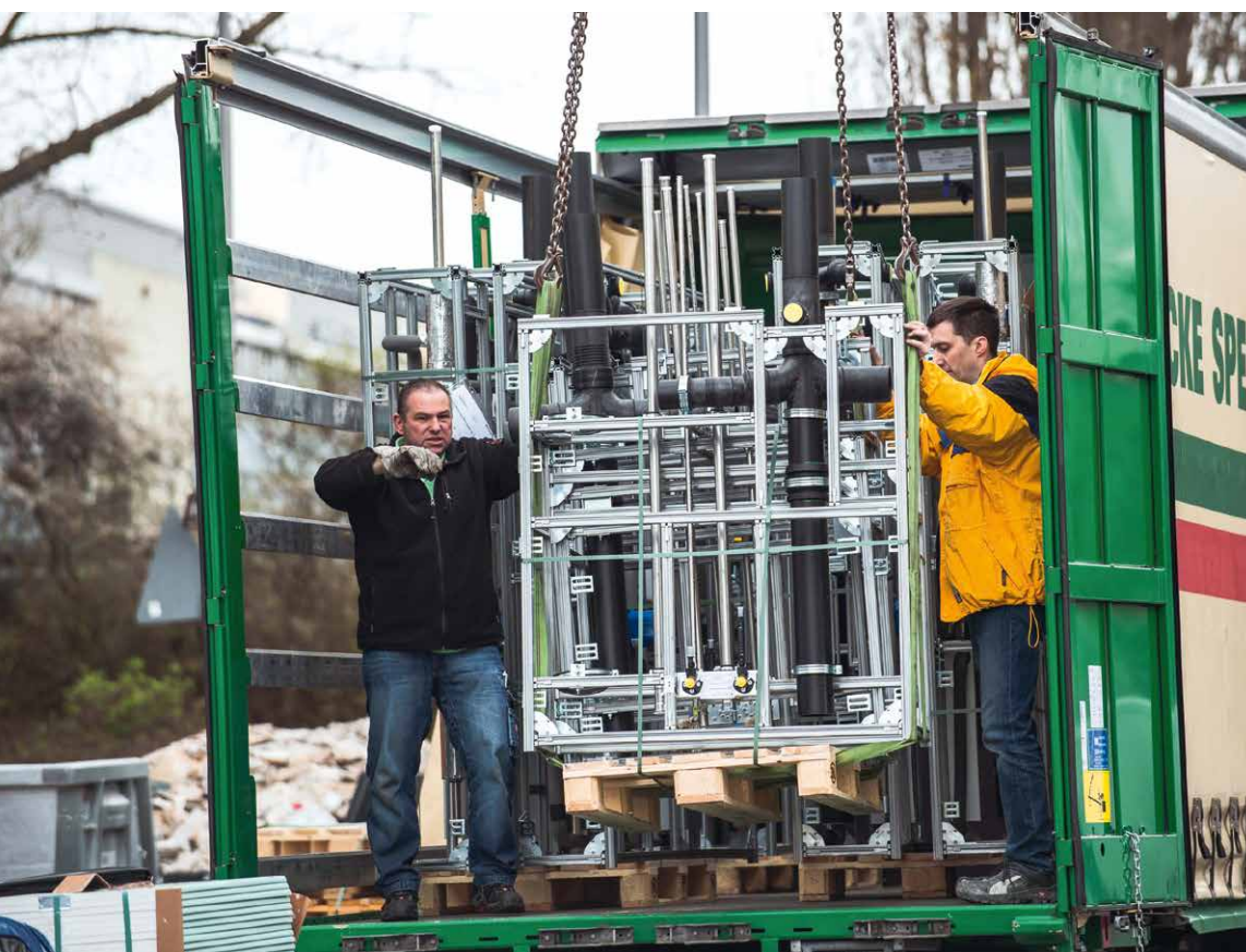
← Die industriell vorgefertigten Sanitärwände Geberit Quattro für die 85 Hotelbäder werden an zwei Liefertagen per LKW auf die Baustelle geliefert.
